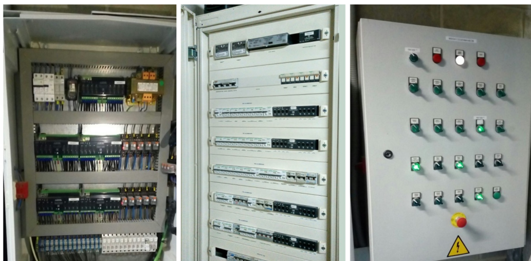
Figura 18. Sistema Teletask integrado con uno de los cuadros eléctricos del pabellón deportivo.
