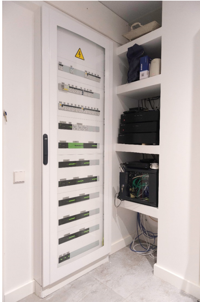
Figura 7. Cuadro eléctrico, servidor de música y amplificador.
