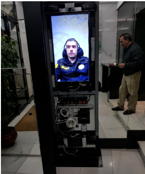
Figura 7. Tótem instalación real de Prosegur Ojo de Halcón.
