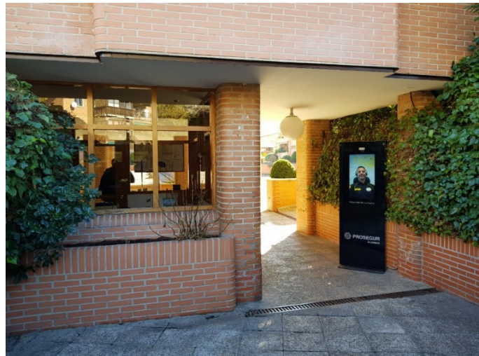
Figura 8. Tótem instalación real de Prosegur Ojo de Halcón.
