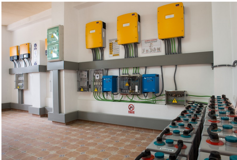
Figura 3. Inversores y baterías del sistema de generación.
